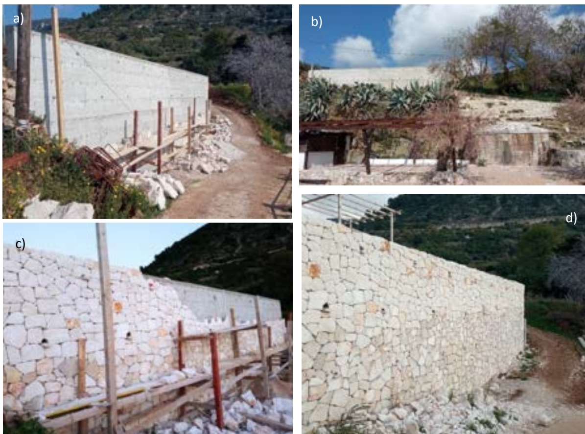
Slika 7. Zid uz pristupni put prema plaži Kamenice: a i b) stanje 28.03.2021., c) stanje 4.12.2021. i d). stanje 20.12.2022.
