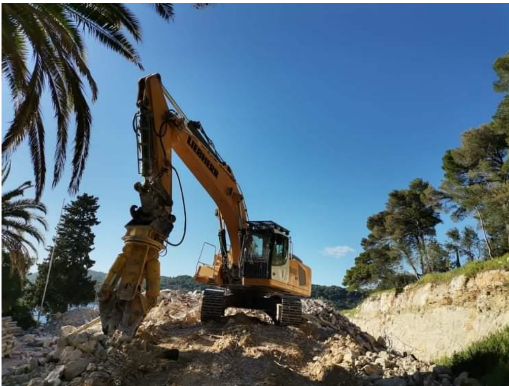
Slika 7. Lokacija objekta Češka vila srušenog do temelja nedavnim građevinskim radovima, stanje 23.02.2022.
